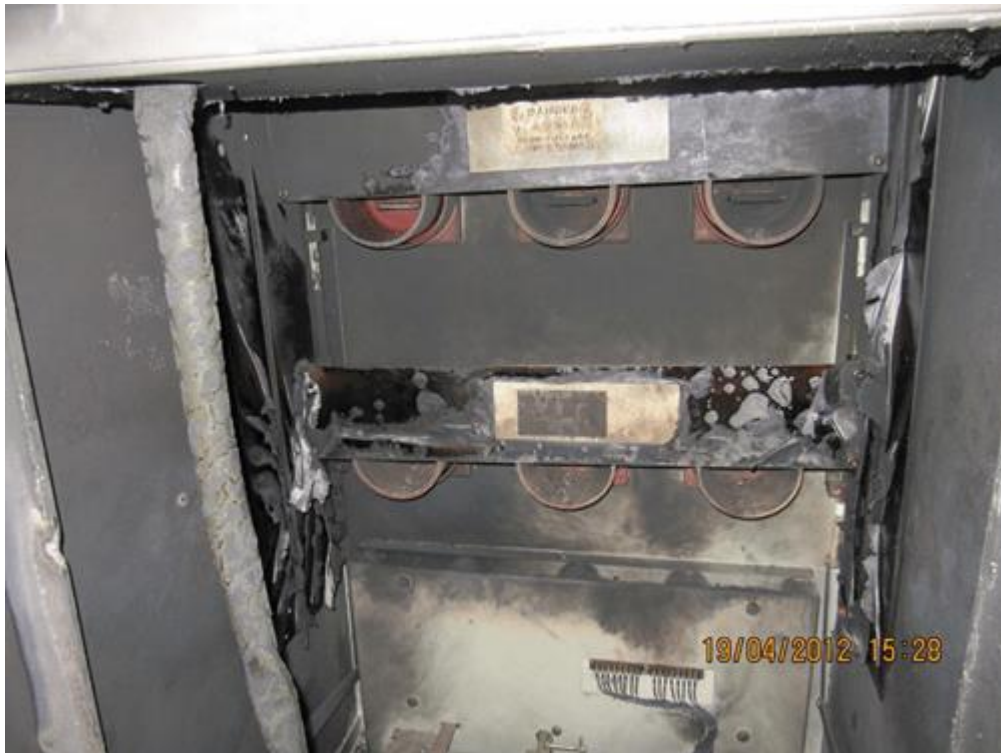
圖 3.台電裝甲開關箱電弧閃光事故
