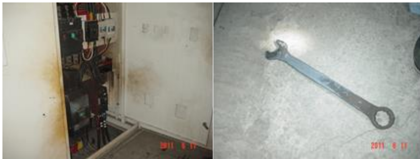
圖 2.事故配電箱及使用之梅開板手
