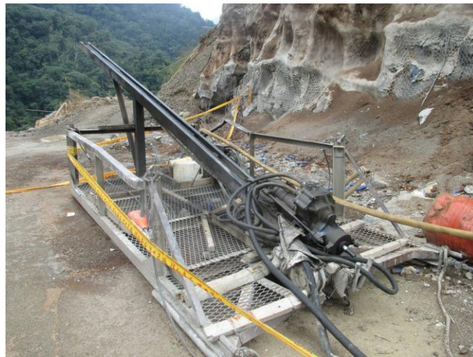
照片說明：發生災害之搭乘設備。
