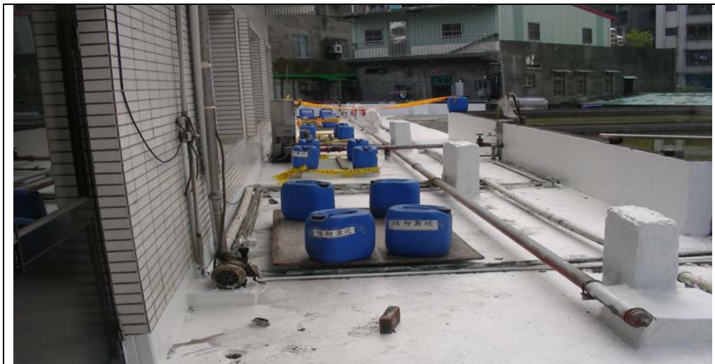
說明 墜落點為事業單位針劑部二樓屋頂第 3 個採光窗
